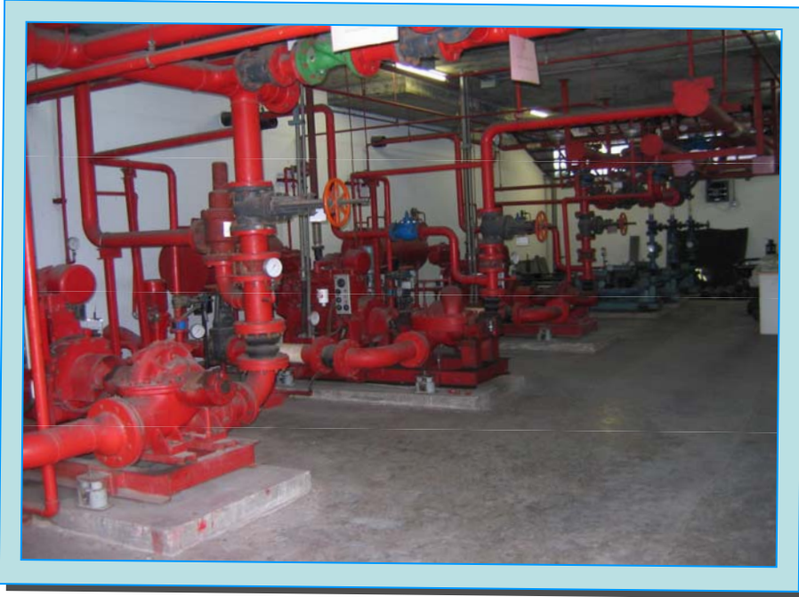
เครื่องปั้มน้ำดับเพลิง
